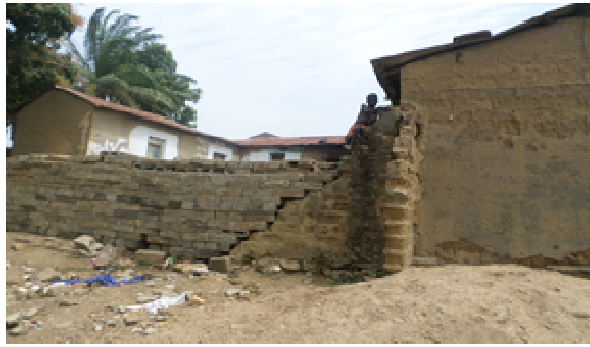
Photo3 : Maison d'habitation à risque d'inondation
