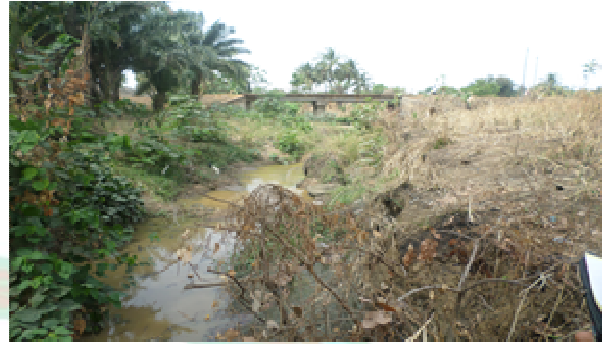
Photo6 : obstruction du lit et du pont
